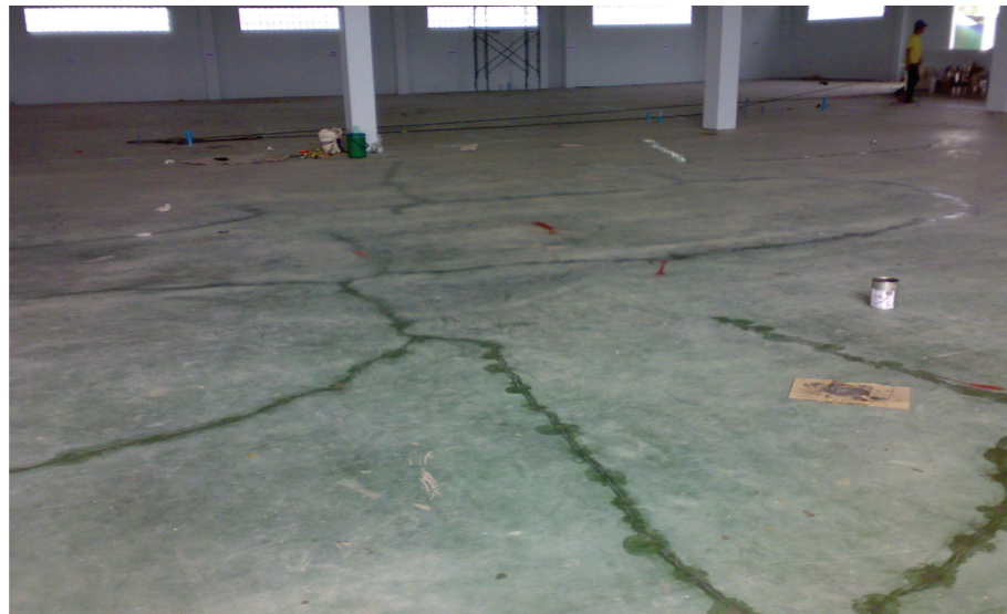
ปัญหาพื้นโรงงานแตกร้าว Pblems In Industrial Floor
