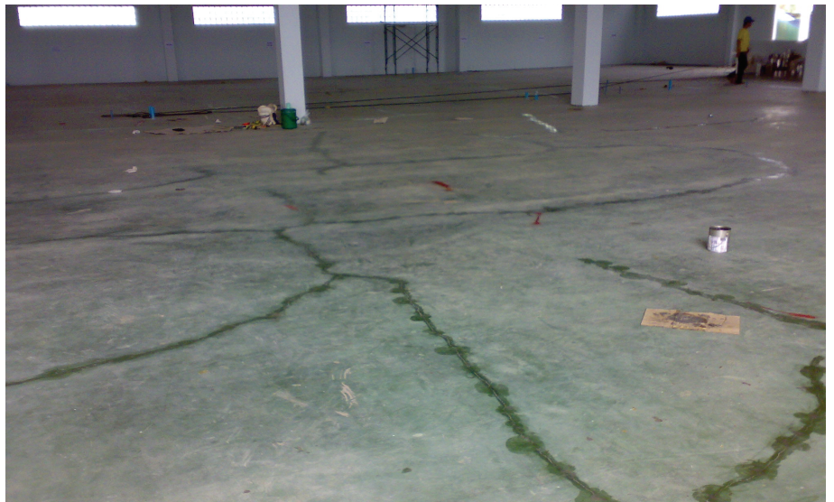
ปัญหาพื้นโรงงานแตกร้าว Problems In Industrial Floor
